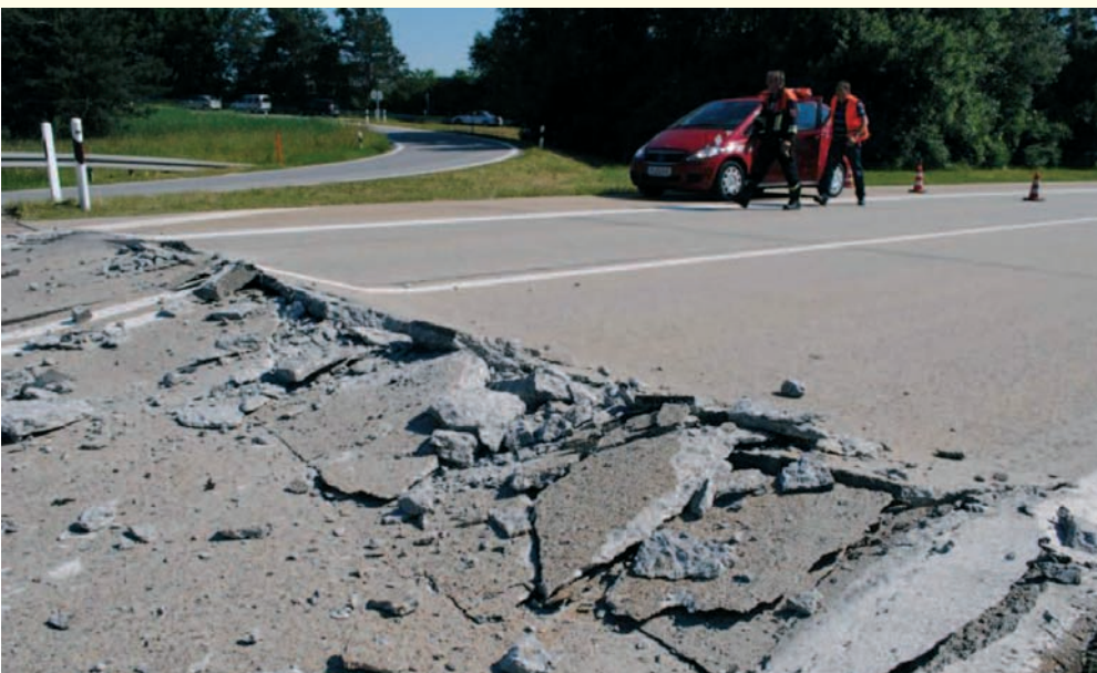
blow ups auf der Autobahn
